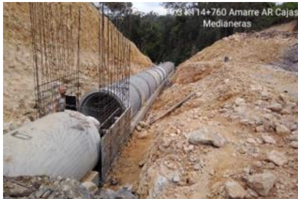
Foto 16. UF9 – Drenajes transversales K114+760
