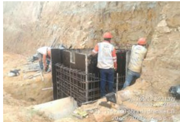
Foto 17. UF9 – Drenajes transversales K115+340
