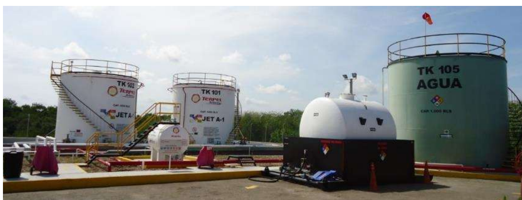
Ilustración 20: Vista de las zonas de combustible junto a la plataforma ECHO
