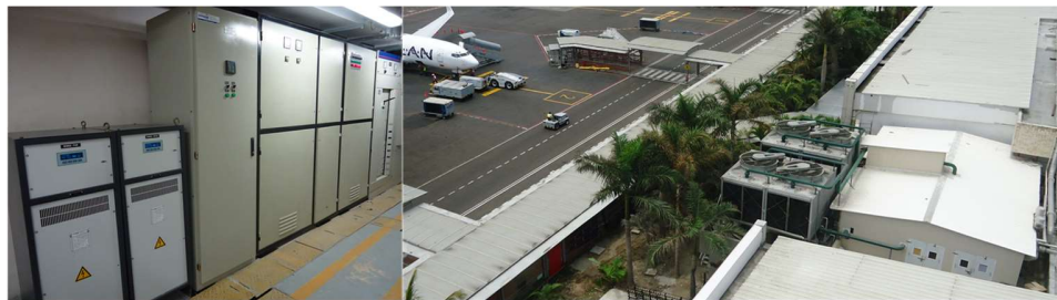
Ilustración 22: Vista del interior de la subestación número 2 y transformadores
