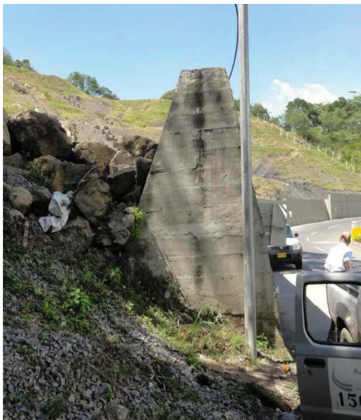
Figura 4-12. Deslizamiento El Cune con drenaje detrás del muro
