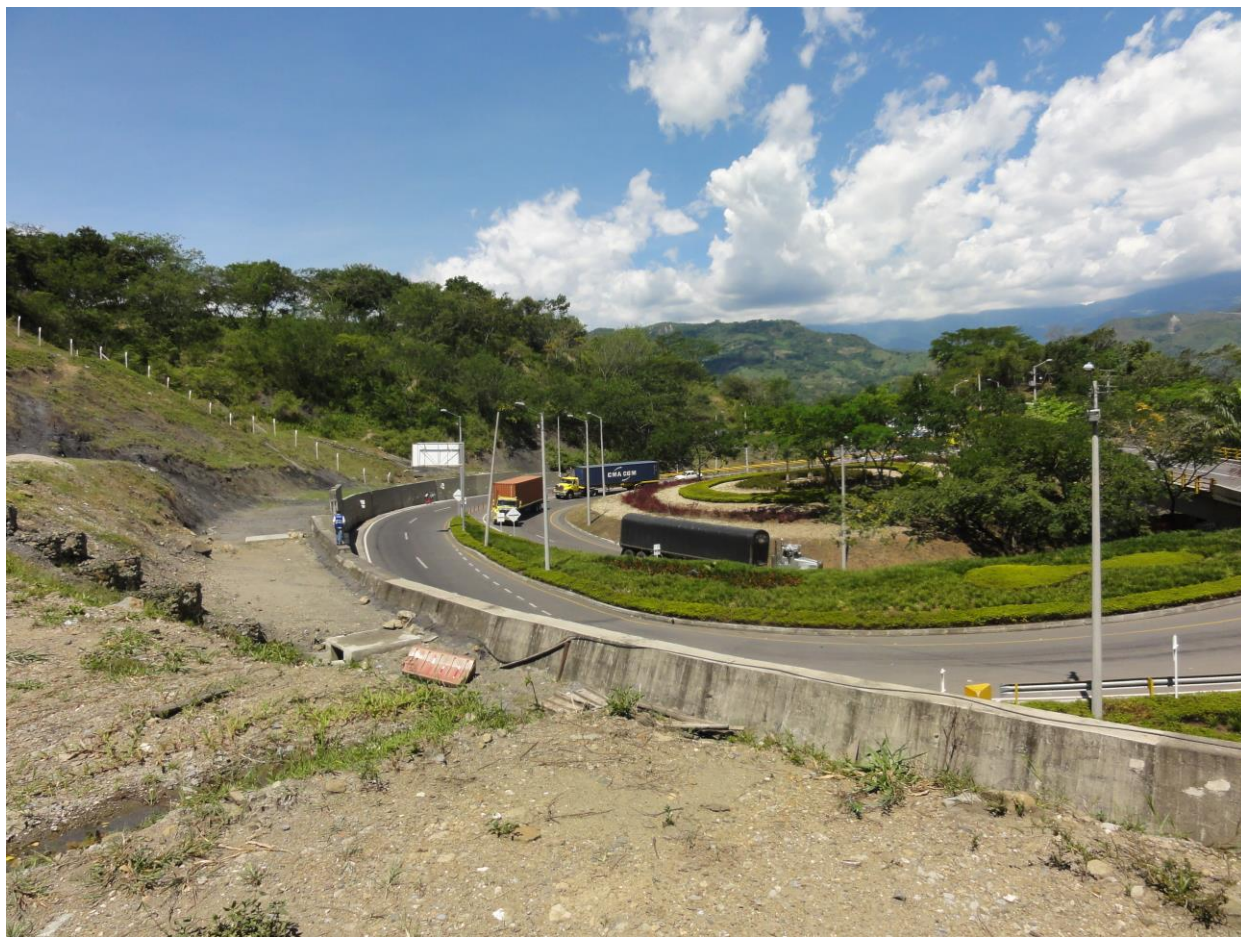
Figura 3. La parte inferior del Deslizamiento del Cune, mostrando los esfuerzos para desviar el agua en el lado izquierdo de la fotografía, la glorieta en la cual el trazado del Tramo 1 comienza, y el muro de contención en concreto. La foto presenta una vista hacia el suroriente.
