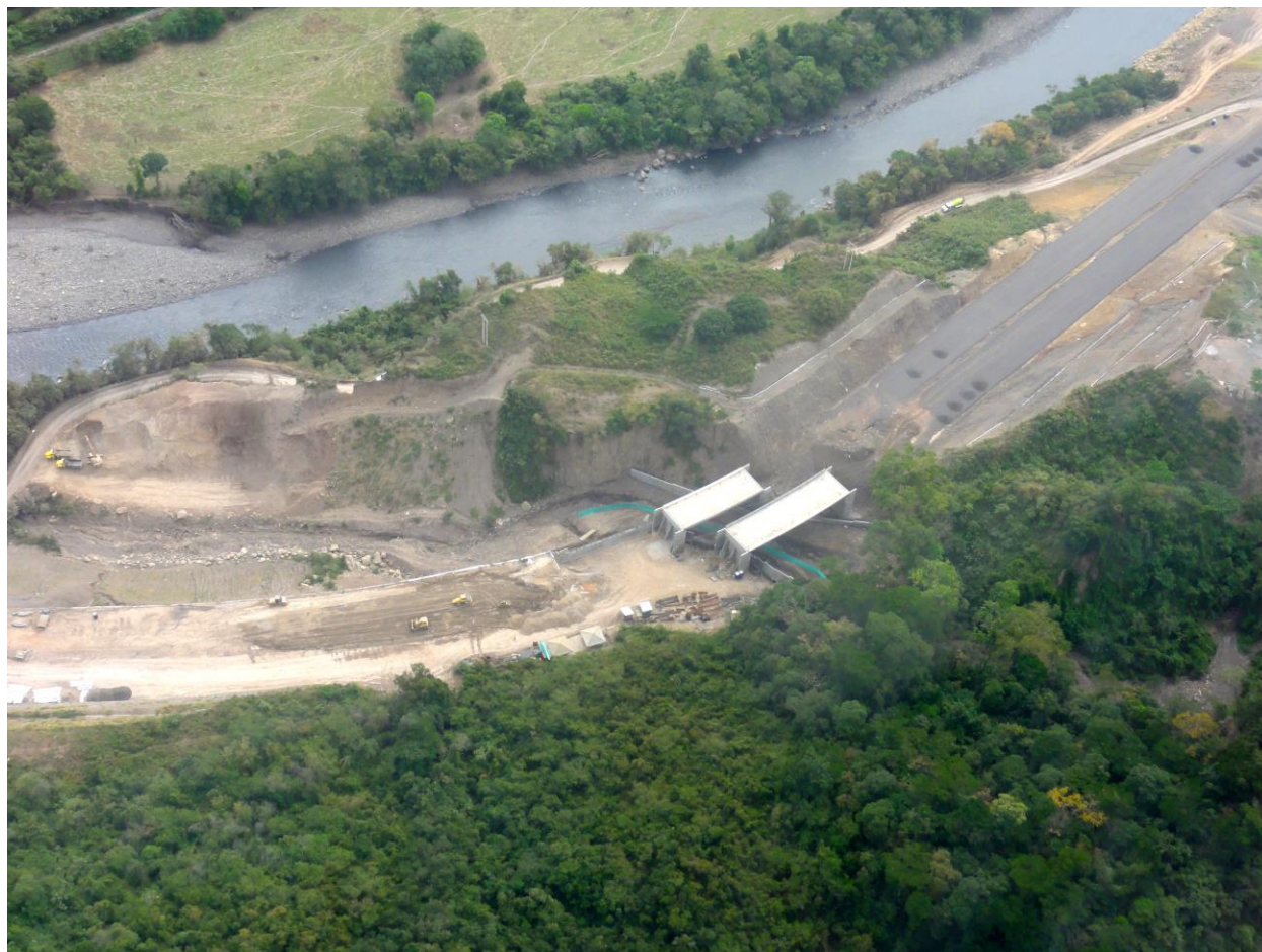
Figura 50. Vista aproximada hacia el noroccidente, esta imagen muestra la construcción de puentes sobre el trazado del Tramo 2.
