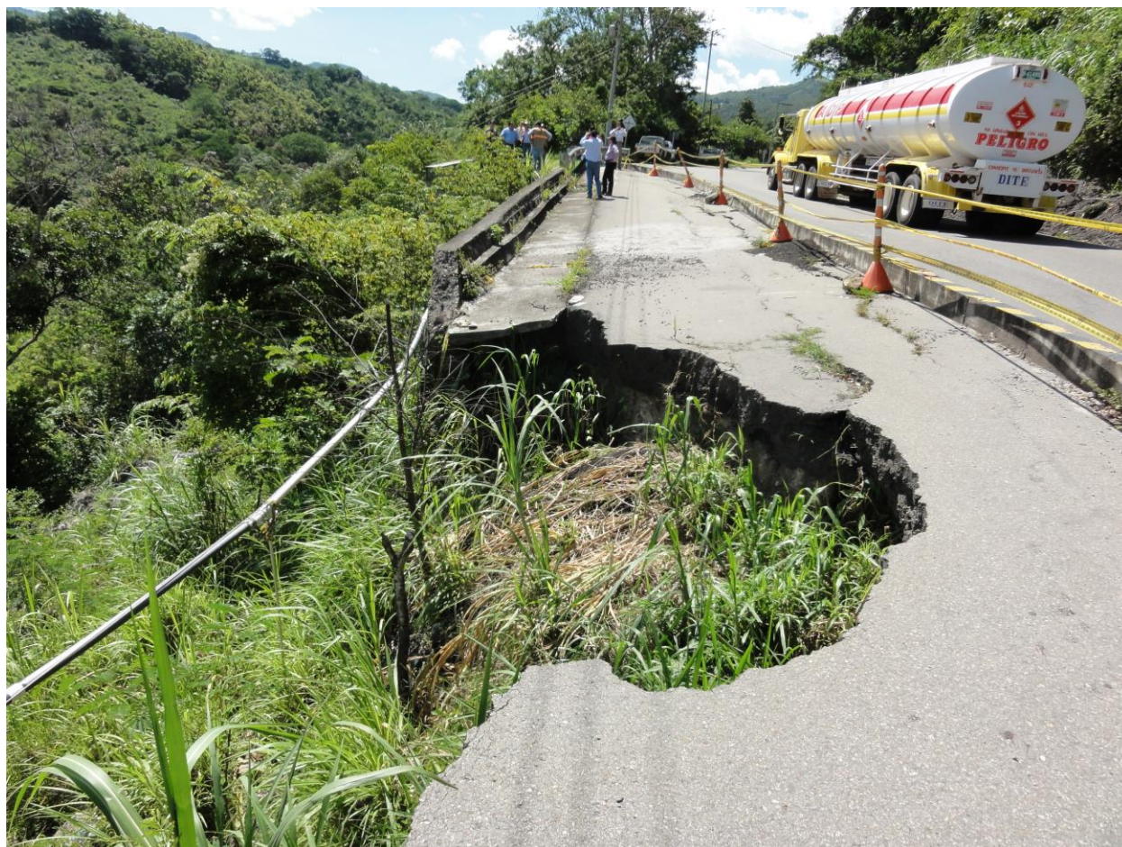
Figura 5. Falla estructural al costado oriental de la Ruta 50, aproximadamente en el K1+000. Ver el camión que viaja hacia Guaduas, esta Ruta es la única arteria vial para todo el tráfico que viaja de Villeta a Guaduas. Un gran volumen de tráfico – incluyendo camiones – es común en la carretera.
