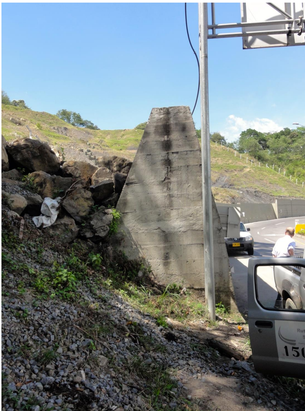
Figura 4. Rocas de arenisca detrás del muro de contención construido posterior al deslizamiento para la estabilización y protección de la vía y el tráfico. La zona libre de vegetación puede verse al fondo.
