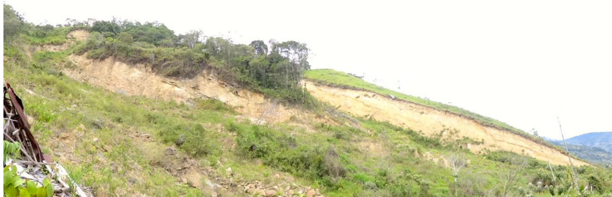
Figura 41. Mirando hacia costado suroriental del deslizamiento, se observa una gran escarpe causado por la falla del talud. Se observan capas intercaladas de areniscas sublíticas y materiales sedimentarios meteorizados de grano fino de la Formación San Juan de Rio Seco.
