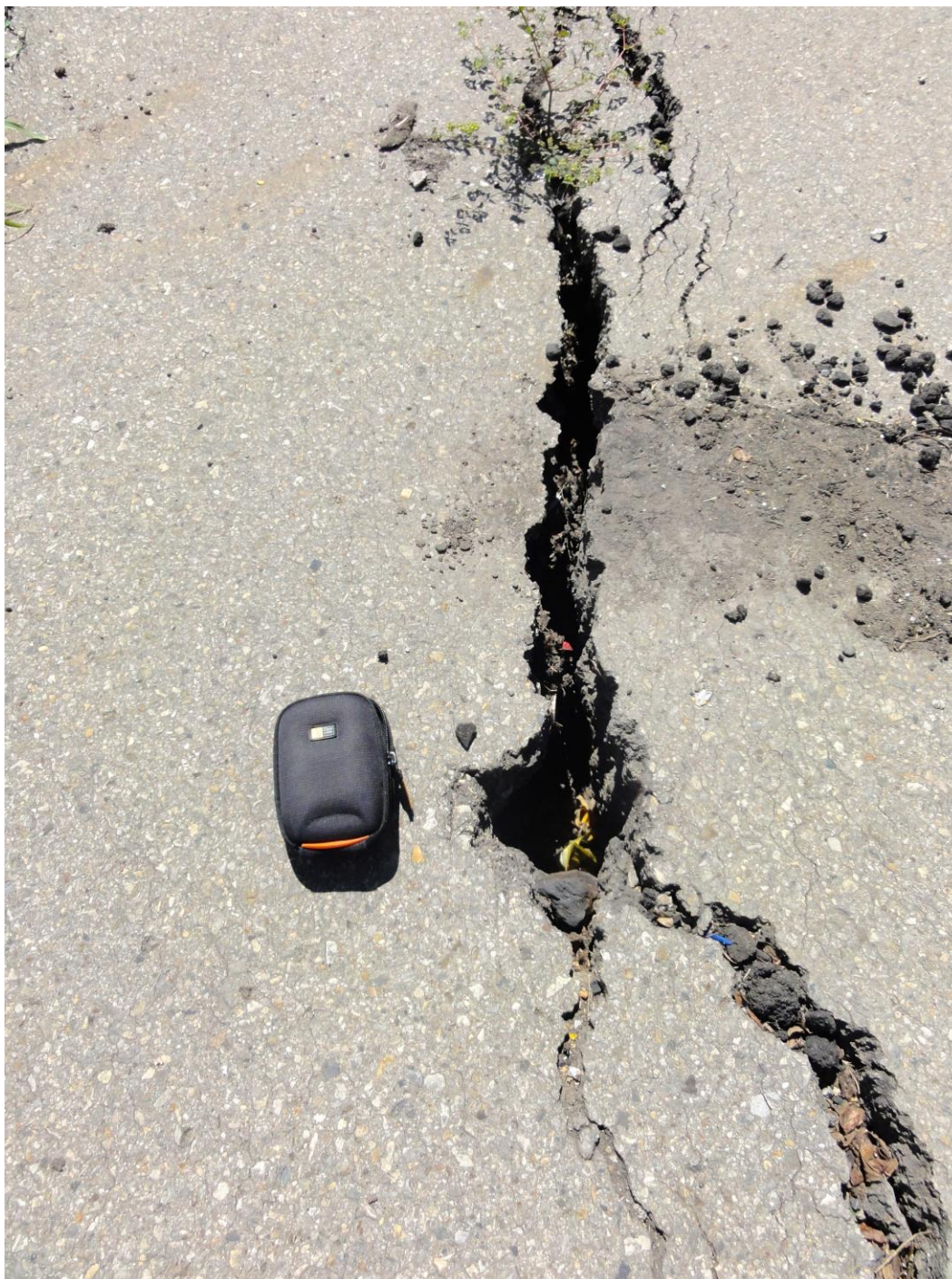
Figura 7. Grieta estructural en la Ruta 50 en el K1+000.
