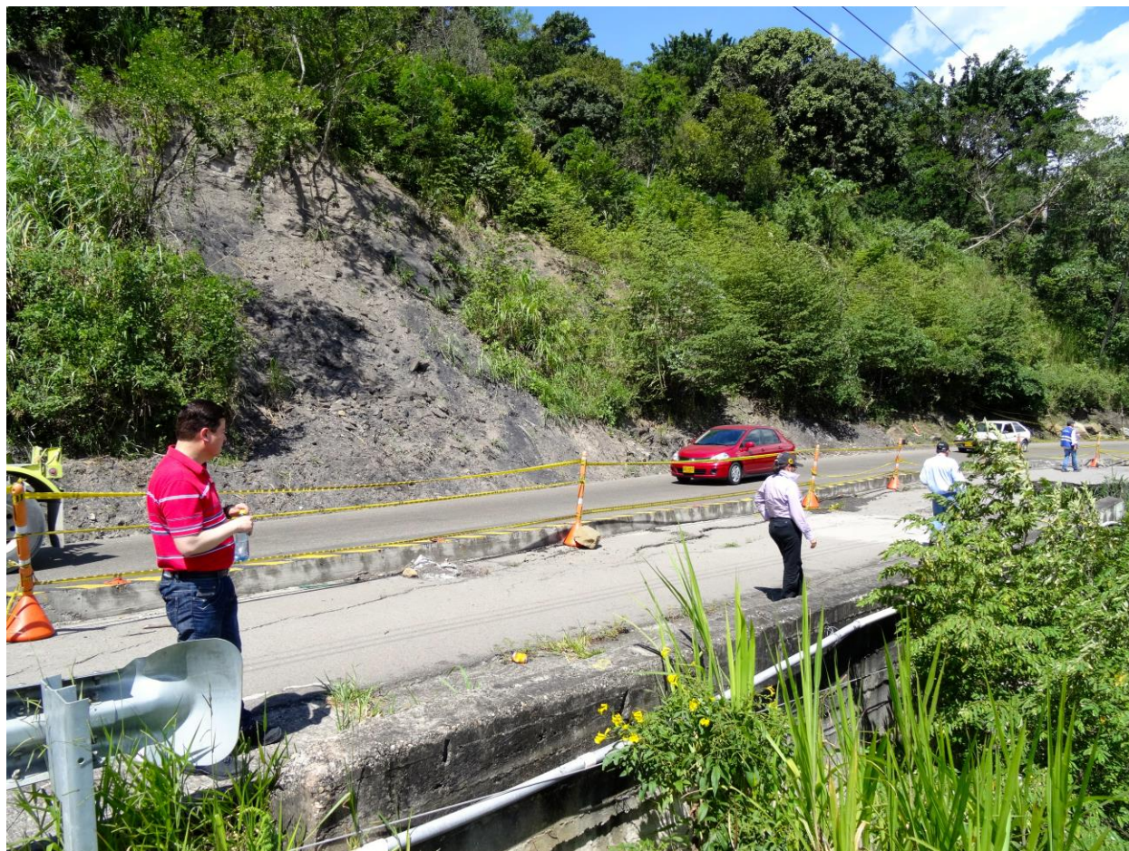
Figura 6. Ruta 50 en el K1+000. Se puede observar daño estructural en la vía, así como falla en la ladera, sedimentos marinos de grano fino de la Formación Trincheras.
