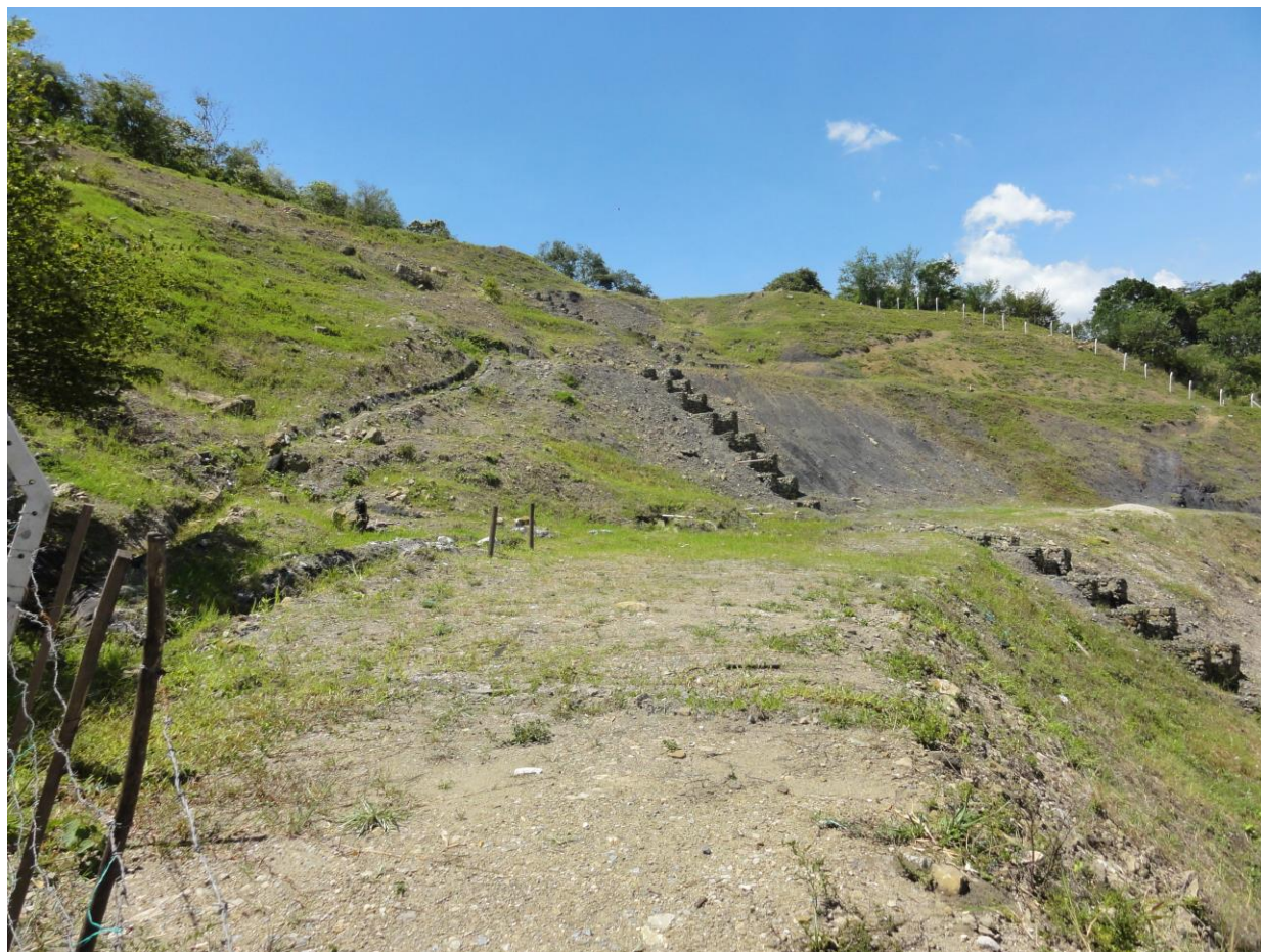
Figura 2. Deslizamiento del Cune, vista hacia el oriente. Ver las rocas sedimentarias meteorizadas que componen la ladera, así como los esfuerzos realizados para conducir el agua superficial.
