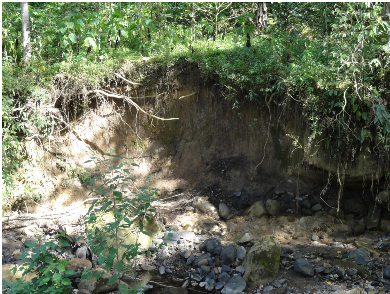
Figura 34. Falla de taludes en sedimentos coluviales debido a la erosión en la parte baja en la banca occidental del Río San Francisco.
