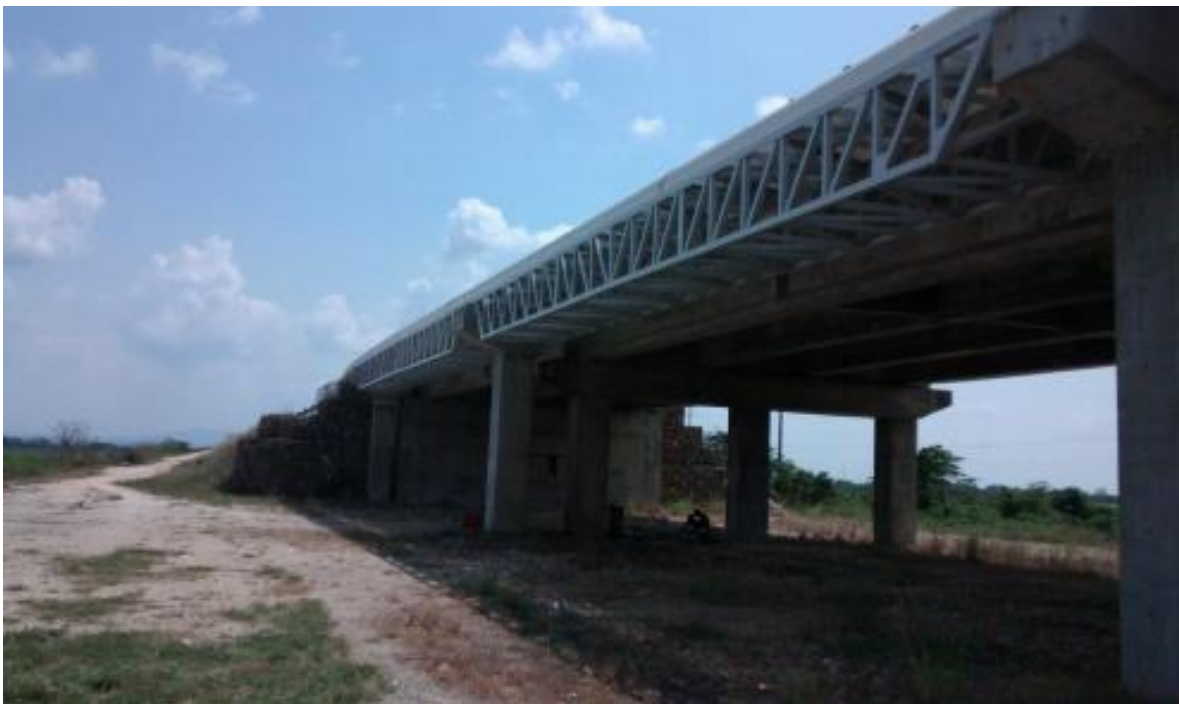
Figura 2-62 Uno de los tres puentes nuevos en la vía Gambote-Arjona que deja una abertura para que pase el agua. Se propone bajar este nivel del fondo con un mínimo de 60cm para permitir que pase el agua.
