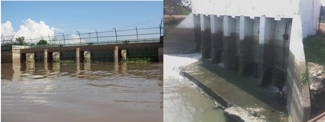
Figura 9. Compuertas Guájaro: El Porvenir (aguas arriba) y Villa Rosa (aguas abajo)
