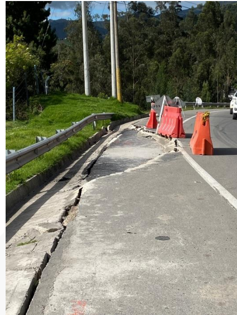
Foto 12. Falla el Guarapo
