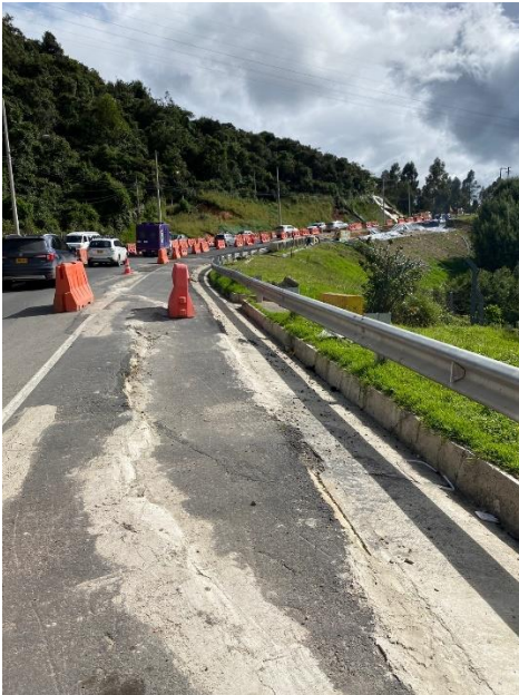
Foto 11. Falla el Guarapo
