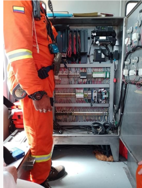
Foto 8. Tablero de control monoboja
