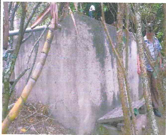
TANQUE DE ABASTECIMIENTO Y POZO
