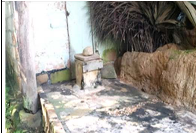
M12: Pozo séptico
