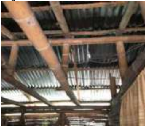
Descripcion cielo raso
