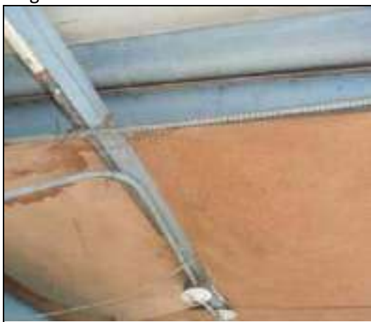
Descripcion cielo raso
