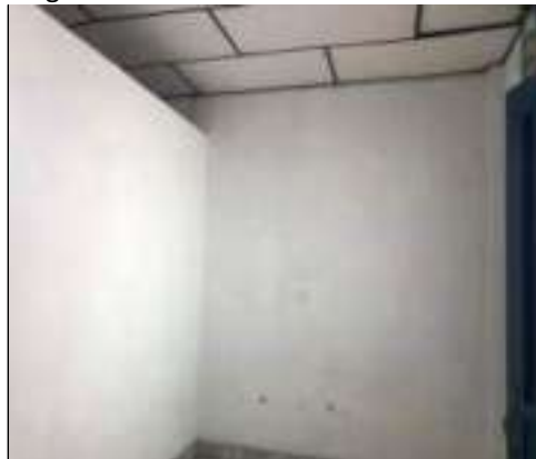
Descripcion CIELO RASO
