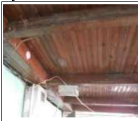
Descripcion cielo raso
