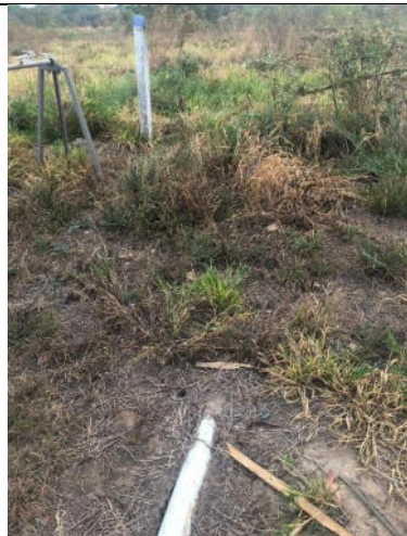
Am4 - acometida Alcantarillado
