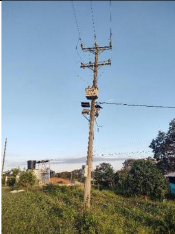
Ps – Poste y Am5 cable para acometida trifásica
