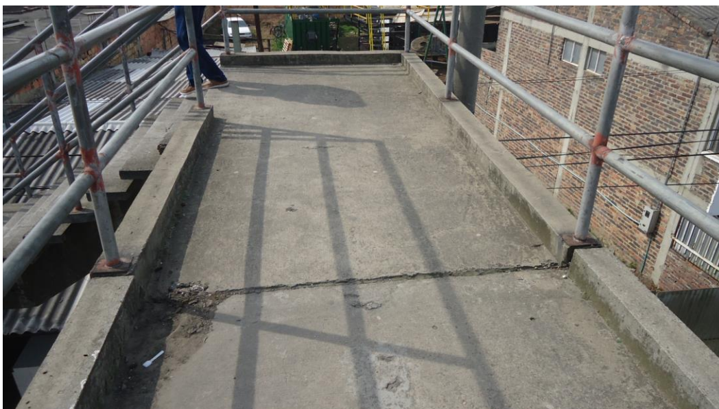
Fotografía No 3. Presencia de fisuras y deterioro placa peatonal
