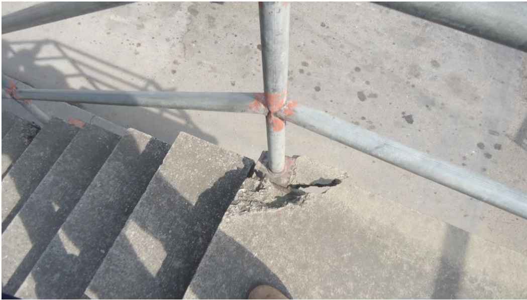
Fotografía No. 2. Estado de las Barandas y sus anclajes
