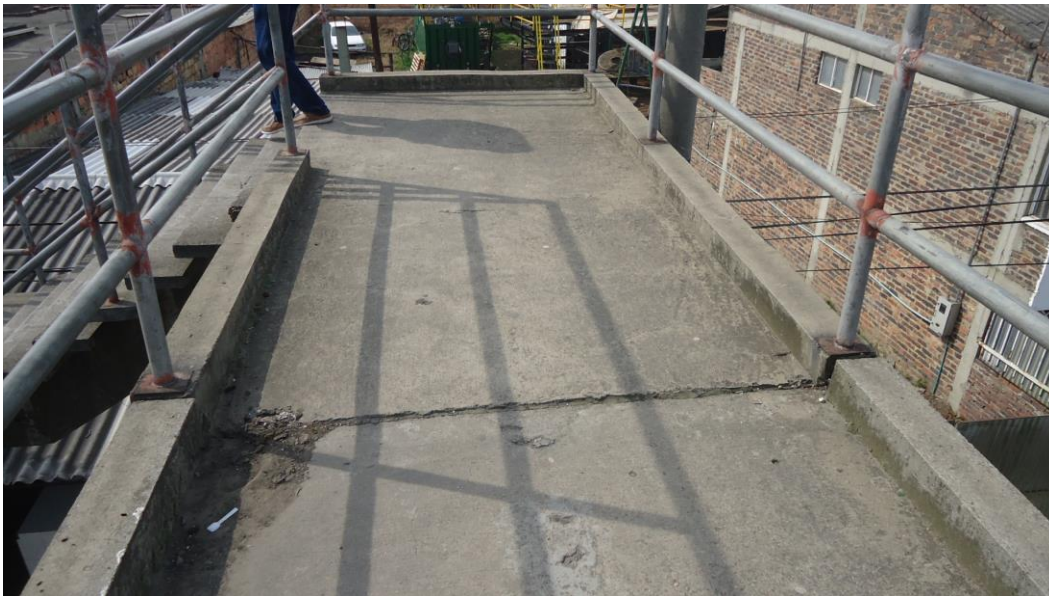
Fotografía No 3. Presencia de fisuras y deterioro placa peatonal
