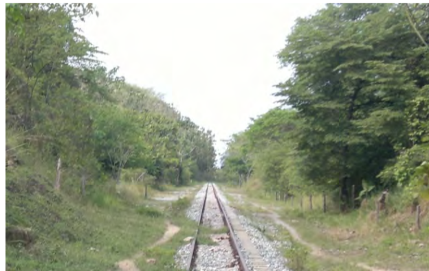
IMÁGENES DEL DESLIZAMIENTO DE TALUDES CON PASO DE FERROVÍA EN CORTE DE LADERA PK 294+940 AL 294+990 EN EL SECTOR COMPRENDIDO ENTRE RAMAL NARE
