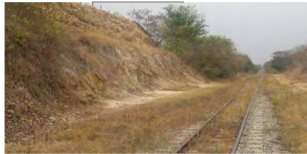
IMÁGENES DEL DESLIZAMIENTO DE TALUDES CON PASO DE FERROVÍA EN CORTE DE LADERA PK 600+210 AL 600+450 EN EL SECTOR COMPRENDIDO ENTRE RAMAL PUERTO CAPULCO
