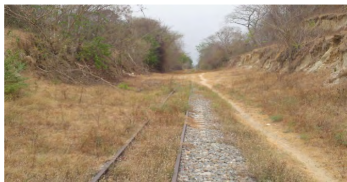
IMÁGENES DEL DESLIZAMIENTO DE TALUDES CON PASO DE FERROVÍA EN CORTE DE LADERA PK 599+800 AL 599+828 EN EL SECTOR COMPRENDIDO ENTRE RAMAL PUERTO CAPULCO
