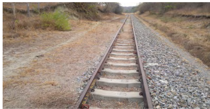
IMÁGENES DEL DESLIZAMIENTO DE TALUDES CON PASO DE FERROVÍA EN CORTE DE LADERA PK 599+730 AL 599+775 EN EL SECTOR COMPRENDIDO ENTRE RAMAL PUERTO CAPULCO
