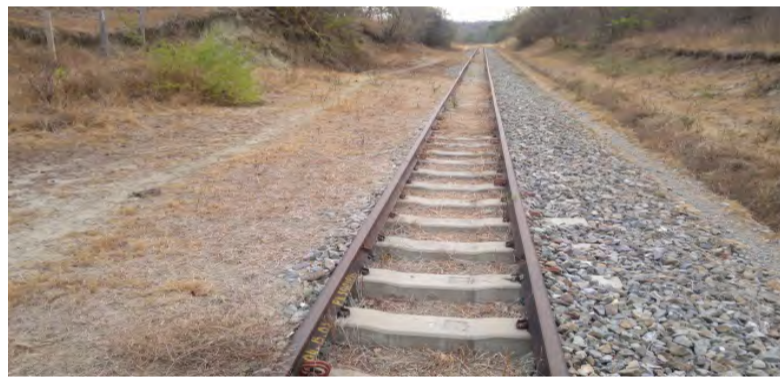
IMÁGENES DEL DESLIZAMIENTO DE TALUDES CON PASO DE FERROVÍA EN CORTE DE LADERA PK 598+645 AL 598+715 EN EL SECTOR COMPRENDIDO ENTRE RAMAL PUERTO CAPULCO
