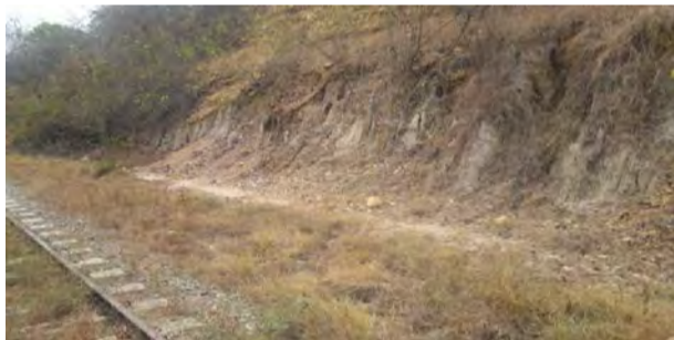
IMÁGENES DEL DESLIZAMIENTO DE TALUDES CON PASO DE FERROVÍA EN CORTE DE LADERA PK 600+280 AL 600+350 EN EL SECTOR COMPRENDIDO ENTRE RAMAL PUERTO CAPULCO
