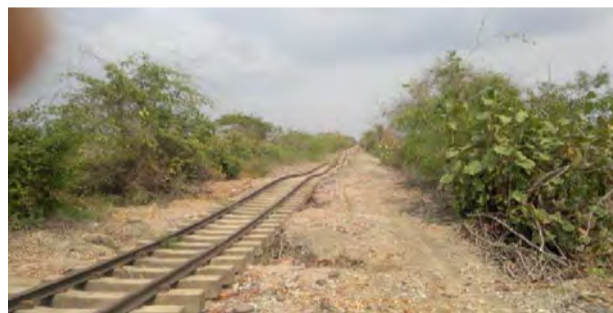
IMÁGENES DEL HUNDIMIENTO DEL TERRAPLÉN FERROVIARIO POR DEFORMACIÓN DE LA SUBRASANTE PK 600+780 AL 601+980 EN EL SECTOR COMPRENDIDO ENTRE RAMAL PUERTO CAPULCO
