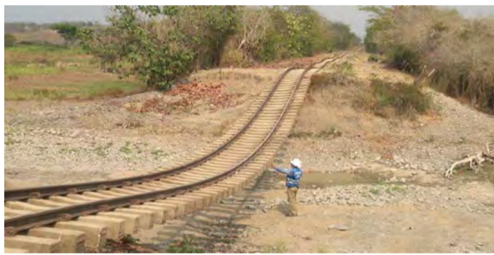
IMÁGENES DEL HUNDIMIENTO DEL TERRAPLÉN FERROVIARIO POR DEFORMACIÓN DE LA SUBRASANTE PK 600+960 AL 601+010 EN EL SECTOR COMPRENDIDO ENTRE RAMAL PUERTO CAPULCO
