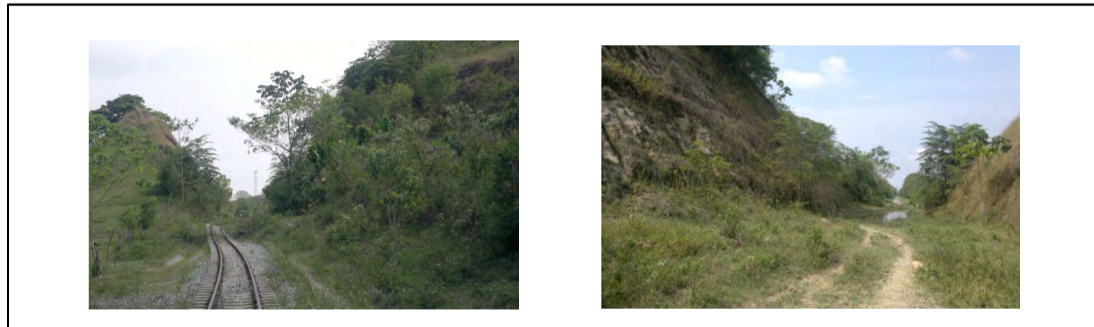
IMÁGENES DEL DESLIZAMIENTO DE TALUDES CON PASO DE FERROVÍA EN CORTE DE LADERA PK 295+025 AL 296+000 EN EL SECTOR COMPRENDIDO ENTRE RAMAL NARE
