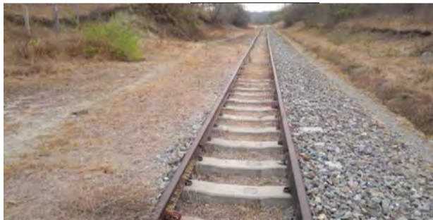
IMÁGENES DEL DESLIZAMIENTO DE TALUDES CON PASO DE FERROVÍA EN CORTE DE LADERA PK 598+825 AL 598+645 EN EL SECTOR COMPRENDIDO ENTRE RAMAL PUERTO CAPULCO
