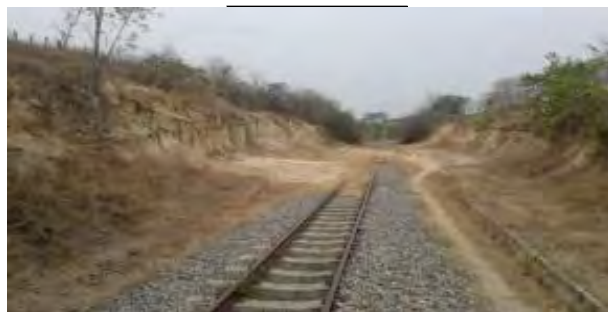
IMÁGENES DEL DESLIZAMIENTO DE TALUDES CON PASO DE FERROVÍA EN CORTE DE LADERA PK 598+605 AL 598+645 EN EL SECTOR COMPRENDIDO ENTRE RAMAL PUERTO CAPULCO
