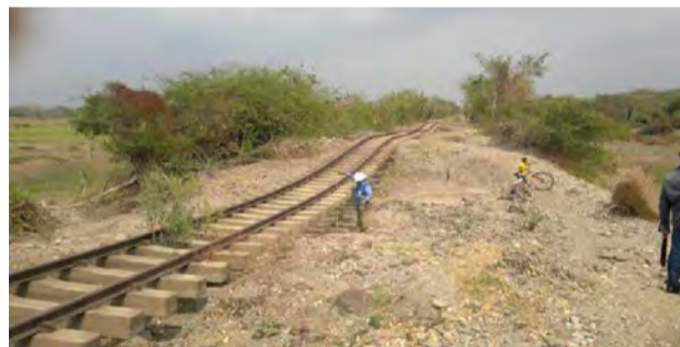
IMÁGENES DEL HUNDIMIENTO DEL TERRAPLÉN FERROVIARIO POR DEFORMACIÓN DE LA SUBRASANTE PK 601+050 AL 601+100 EN EL SECTOR COMPRENDIDO ENTRE RAMAL PUERTO CAPULCO
