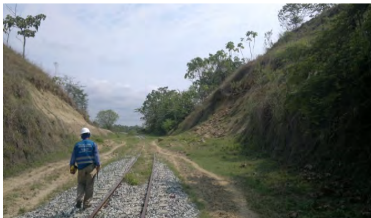
IMÁGENES DEL DESLIZAMIENTO DE TALUDES CON PASO DE FERROVÍA EN CORTE DE LADERA PK 296+430 AL 296+570 EN EL SECTOR COMPRENDIDO ENTRE RAMAL NARE
