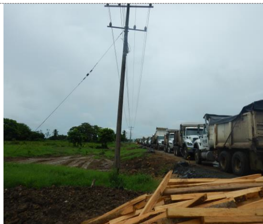
R4. POSTE DE ENERGÍA
