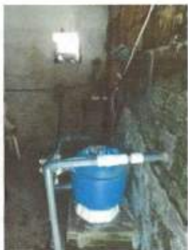
C2: CONSTRUCCIÓN 2 – CUARTO DE MAQUINAS
