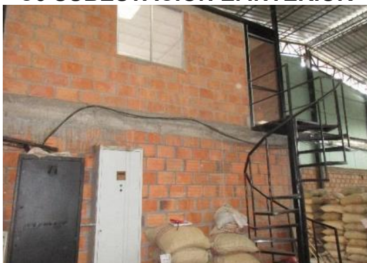
C3 SUBESTACIÓN E. INTERIOR
