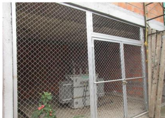
C3 SUBESTACIÓN E.
