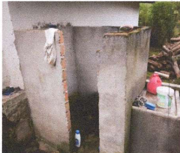
CUARTO DE DUCHA Y LAVADERO
