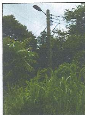
CA8MJ1: Poste de energía
