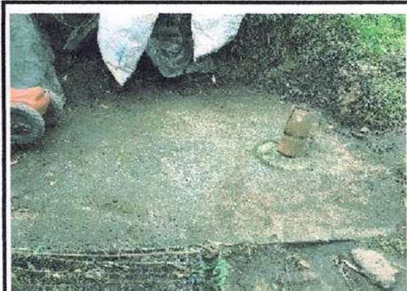
A10 POZO SEPTICO
