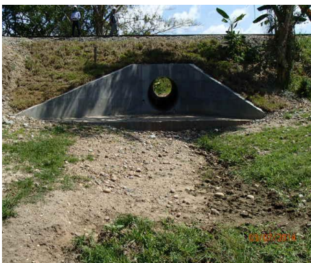
Punto crítico No 1. PK 230+600
