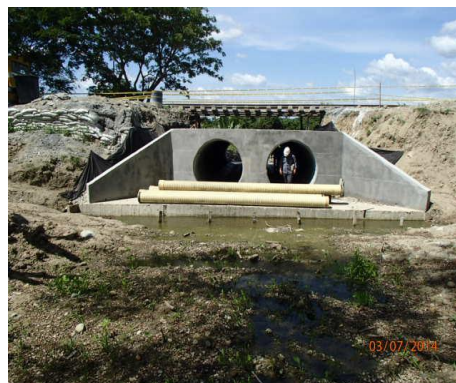
Punto crítico No. 2 PK 235+540
