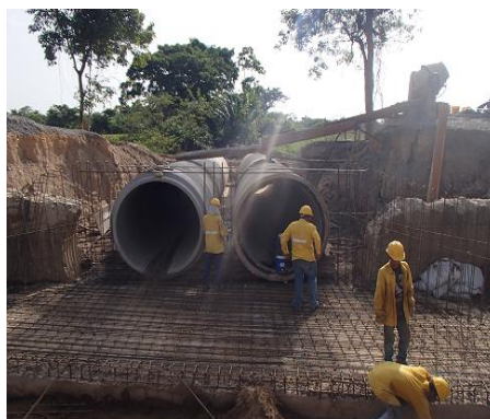
Punto crítico No. 48 PK 678+500
