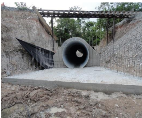
Punto crítico No 20. PK 388+200
