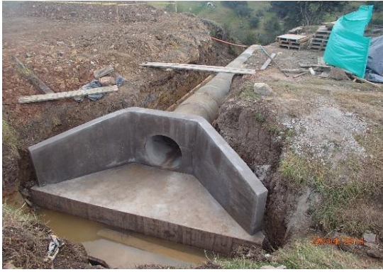
Punto crítico No 46. PK 158+300
