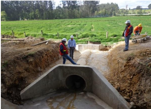
Punto crítico No 67. PK 212+600
