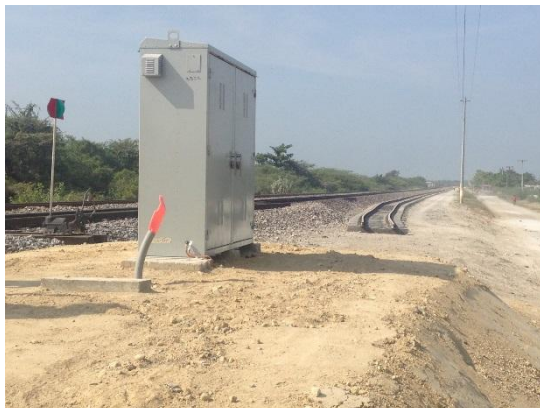
Controlador de cambiavías M23 instalado en el PK 928
