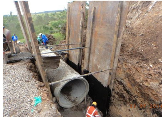
Punto crítico No. 48 PK 163+500
